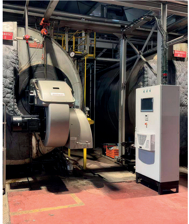
Παράδοση του έργου : Καυστήρας σε λειτουργία & νέος ηλεκτρολογικός πίνακας
