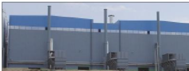
Φωτ.5. Τα τρία RTO και πίσω τους η μονάδα ξήρανσης της Λυματολόσσης
