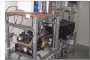
Σχήμα 7: Η κυψέλη καυσίμου με τη διάταξη ηλεκτρόλυσης στο container
