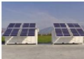
Σχήμα 2: Η Φ/Β διάταξη της εφαρμογής (5kWp) με τους οικίσκους στους οποίους στεγάζεται το σύστημα
