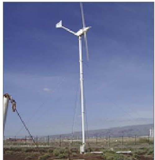
Pozo Izquierdo, ITC, 15 kW Α/Γ
