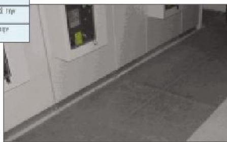
Εικόνα 3. Μονωτικό χαλί προστασίας από ηλεκτροπληξία, εμπρός από ηλεκτρικούς πίνακες Μέσης Τάσης.
