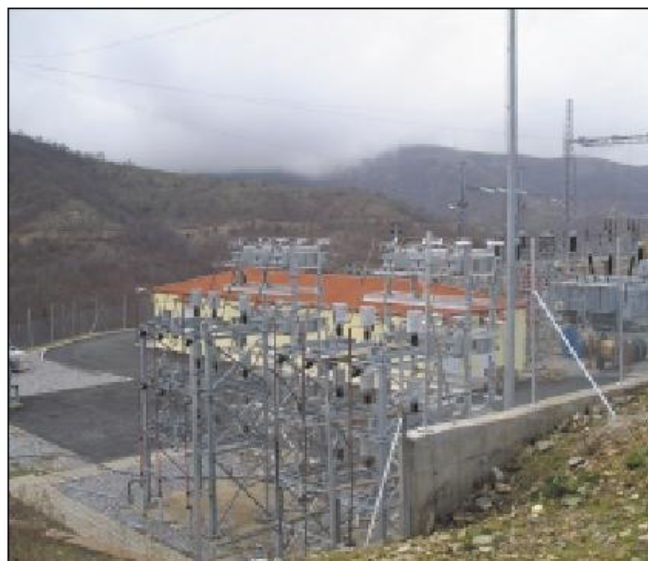
Υ/Σ 20/150 KV 40/50 MVA για Διασύνδεση ΑΠ Δίδυμος
