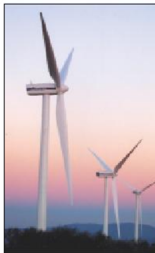
ΑΠ Δίδυμος ισχύος 26 MW στη Θράκη
