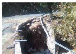
4. Καταστροφή παλαιού γεφυρού και σπασίμων ασφαλτών στη συμβολή χ. Χάλαρη και δημοτικής οδού Γεμελιά.
