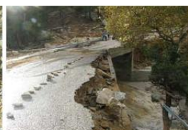
5. Σοβαρές ζημιές στη γέφυρα Γεμελιά - Βρακάδες.
