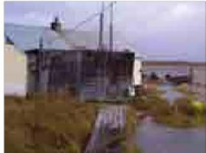
Τα νερά έχουν εκκρηκώσει στο Newtok της Αλάσκα, καταστρέφοντας τις υποδομές
